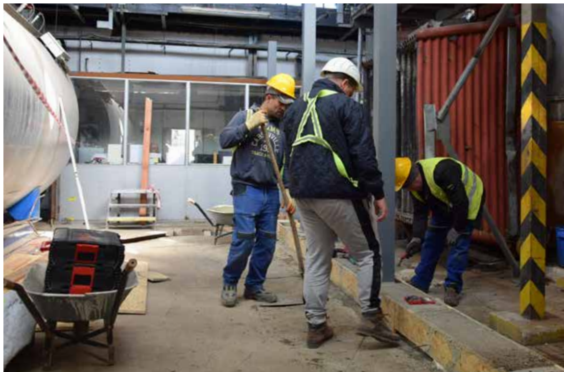
CENTRUM ŘÍZENÍ SPALOVNY se nyní společně s velínem kotelny přesune do nového prostoru energetického centra.
